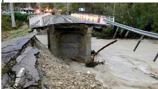
Рисунок 8.2 – Разрушение моста через р. Макопсе
