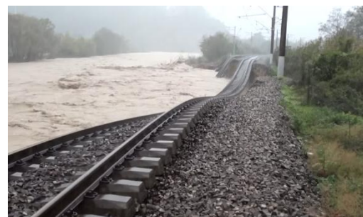
Рисунок 8.3 – Разрушение берегового укрепления, размыв ж/д полотна в Сочи
